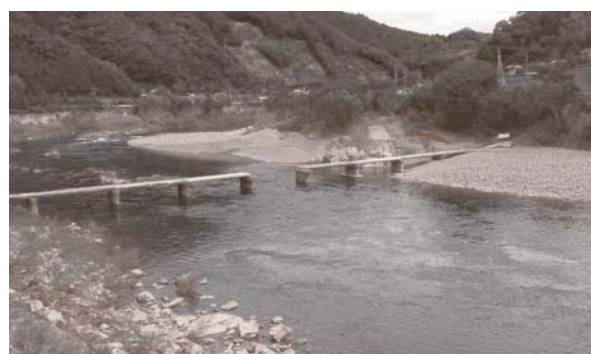
長生沈下橋の被災状況
