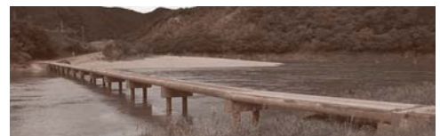
補強工事が急がれる三里沈下橋
