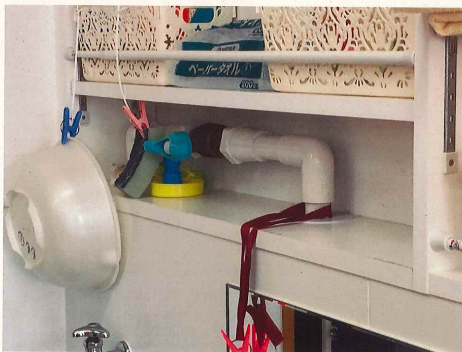
水道の元栓を保育士が閉めることができるようにしている。
